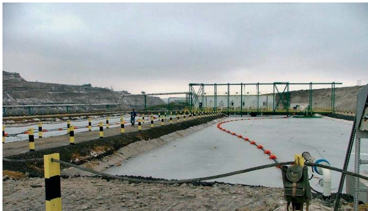
pompownia w T5 w Kopalni Węgla Brunatnego "Turów"
